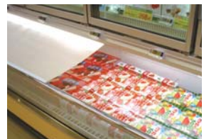
ナイトカバーを設置した冷凍ケース
