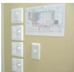
連続調光設備
