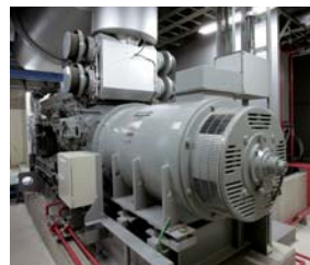
発電設備の更新
