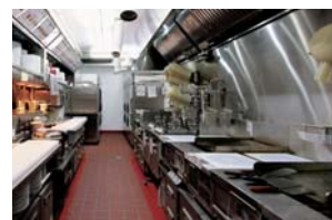
オール電化店舗の厨房
