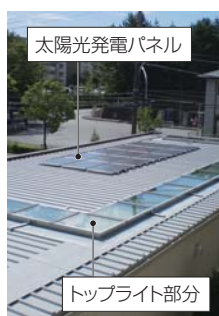
屋上に設置した太陽光発電パネル
